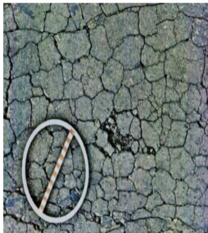
Figura 4 - Fissuras do tipo couro de jacaré em pavimento flexível.
